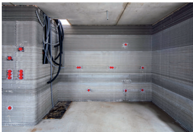
Der 3D-Drucker berücksichtigt bei der Errichtung der Innenwände auch die spätere Verlegung von Leitungen und Anschlüssen.
