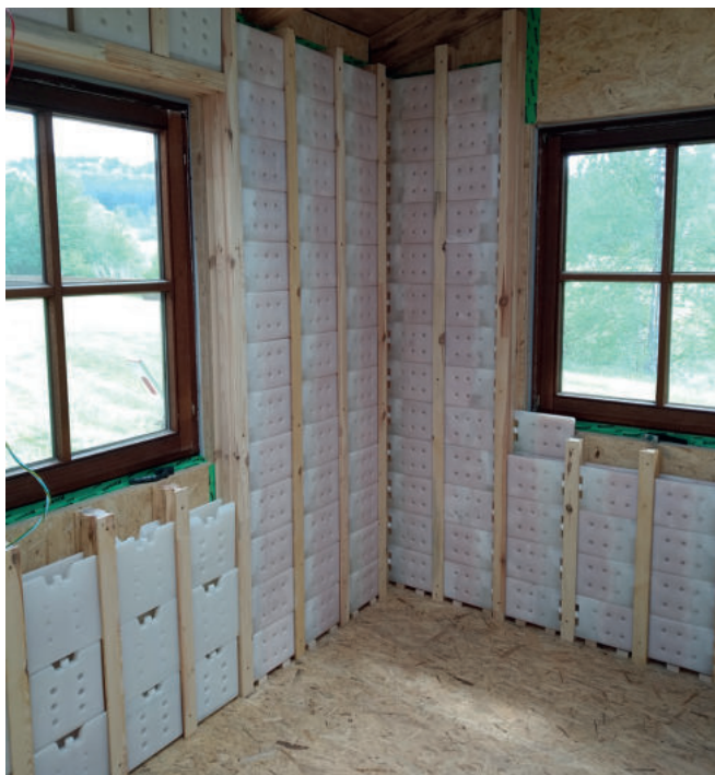
In einem Testgebäude wurden insgesamt 992 kg des Phasenwechselmaterials PCM verbaut. Fotos: Kompetenzzentrum CeMOS
